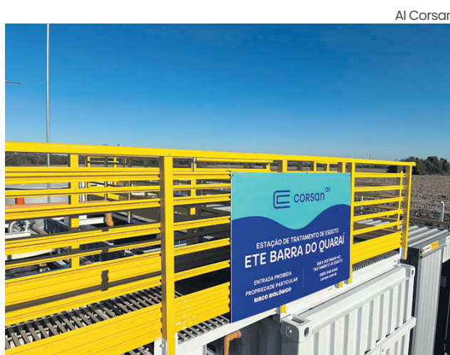
EQUIPAMENTO FOI INSTALADO EM BARRA DO QUARAÍ, NA FRONTEIRA OESTE DO RS, COM CAPACIDADE DE TRATAR 518 MIL LITROS DE ESGOTO POR DIA
